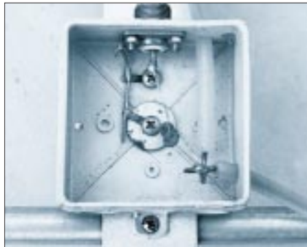
Bild 3: Die Ausführung der Koaxialkabel-einspeisung
